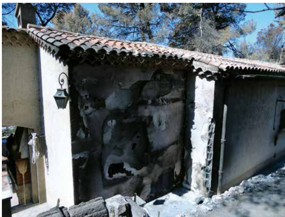
La vulnérabilité dépend beaucoup de l'aménagement microlocal de l'interface, du jardin d'agrément cernant le bâti, de la présence ou non de facteurs aggravants (tas de bois à proximité).
